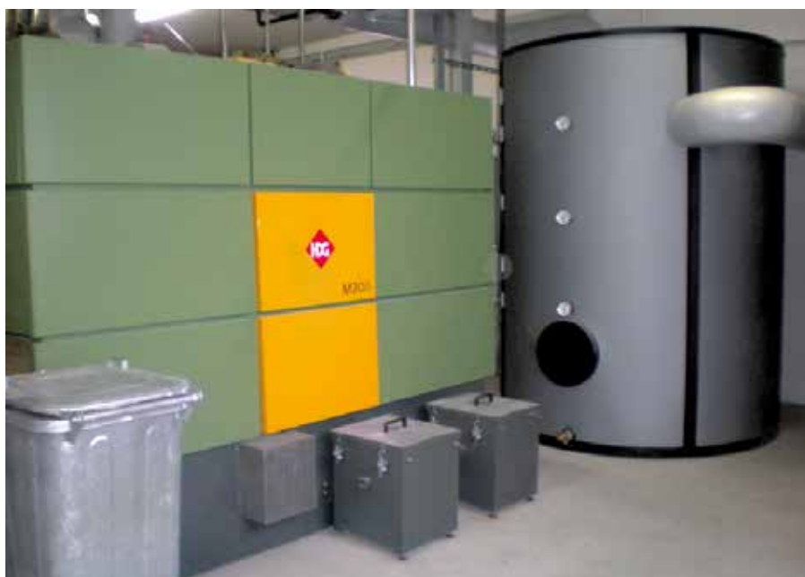
I praktiken finns det ofta en ackumulator på M300-400. Tack vare den varvtalsstyrda ackumulatorpumpen uppnår man särskilt effektiv värmeöverföring och lämplig volymström i hela effektspektret.
